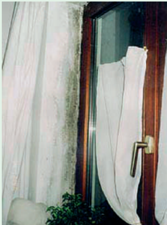
Durch die Abkühlung der Fensterumgebungsflächen wird die Schimmelpilzbildung gefördert.
